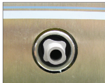
Installierte Abflussarmatur mit abgenommener Kappe
