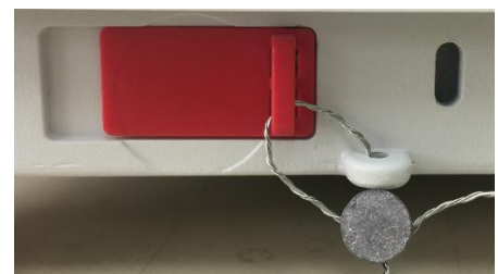
Bloqueado con cable de sellado
